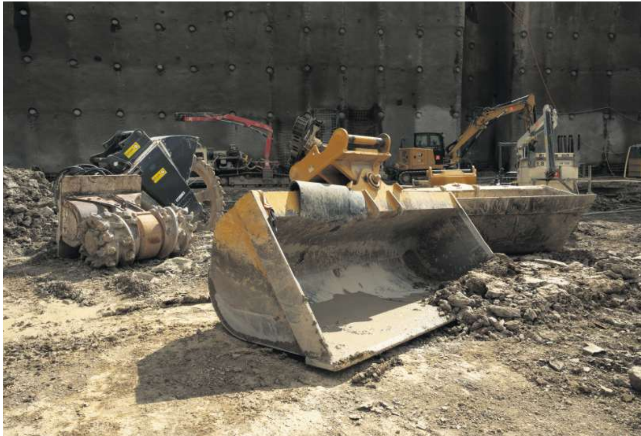
Auf verschiedenen Baustellen im Kanton wird sich in der nächsten Zeit nichts tun.
